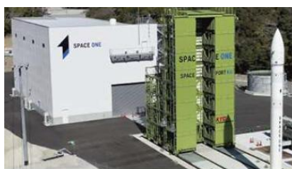
当社移動式射点組立足場とロケット (和歌山県串本町)
